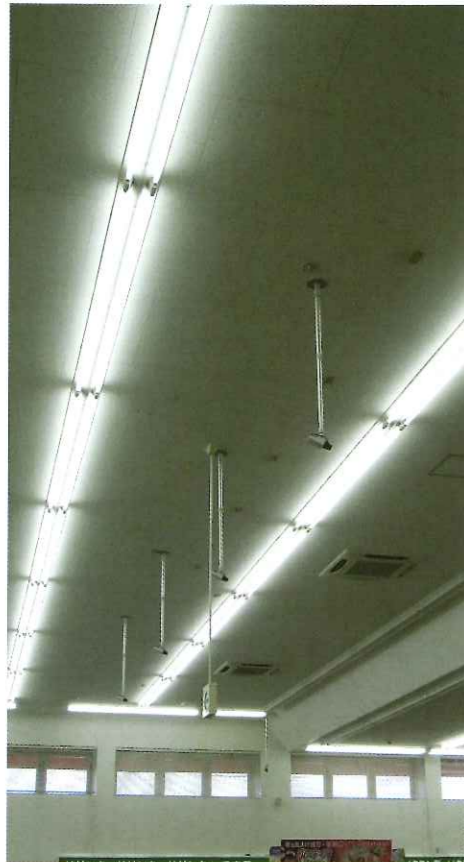
ドラッグストア設置事例
