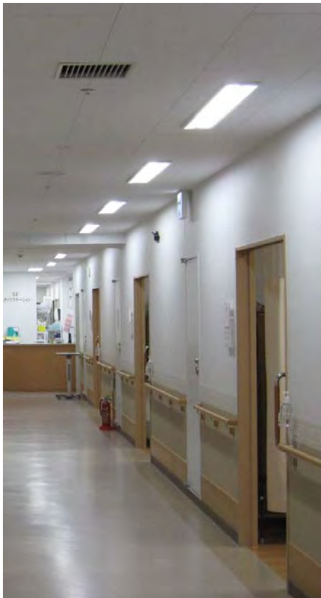
常備点灯廊下設置事例
